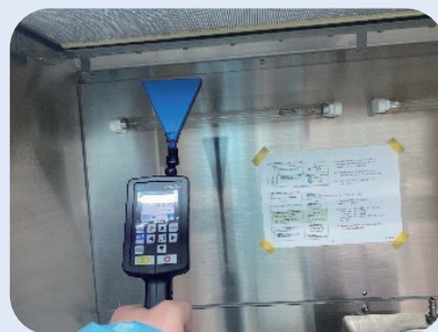
(HEPAフィルターリーク測定)
